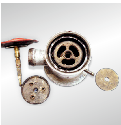
Rys. 30 Odtłaczalny zawór zwrotny – uszkodzenia membrany oraz talerza zaworu przez kondensat
