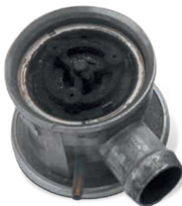
Škody způsobené kondenzátem spalín
