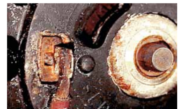
Bomba de ar secundário – ligações eléctricas corroídas
