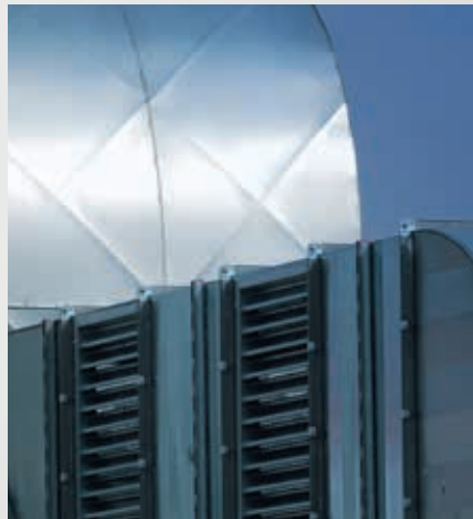
Impianto di ventilazione
