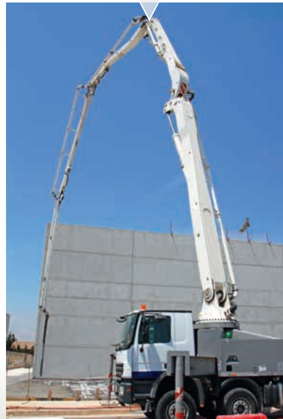
Mât distributeur en béton
