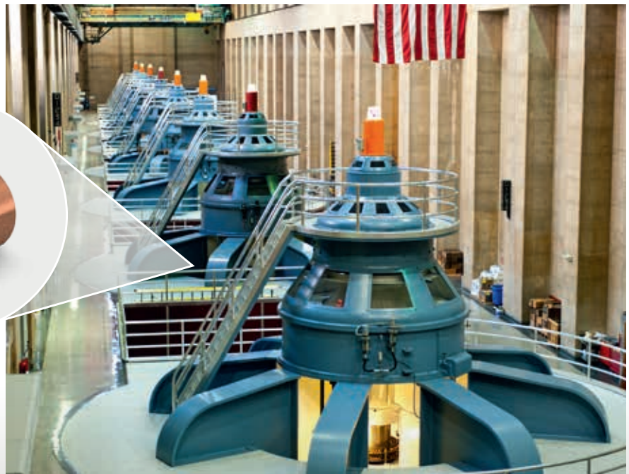
Turbina de la presa Hoover
