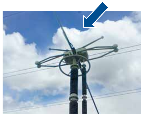
Fig. 6: Aplicación en interruptores de alta tensión
