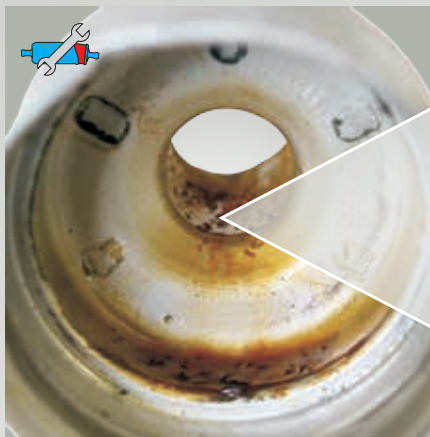
Abb. 64: kristalline Ablagerungen durch unzulässiges Medium
