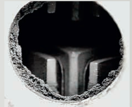
Fig. 31: Sedimentos en la válvula de retención
