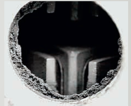
Abb. 31: Ablagerungen am Rückschlagventil
