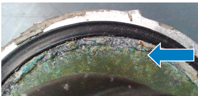
Líquido de refrigeração inadequado causou corrosão e fugas
