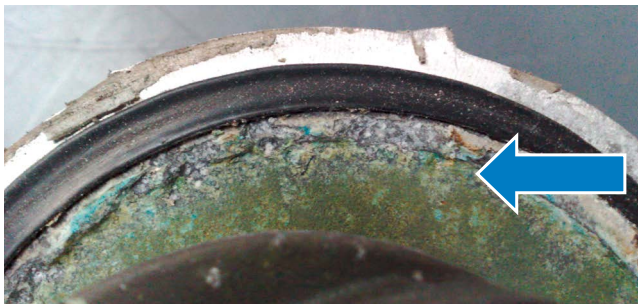
不合适的冷却液造成腐蚀和泄漏
