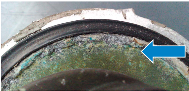
Uygun olmayan soğutma sıvısı, korozyona ve sızıntılara neden oldu
