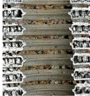
Zulaufkanal mit Verunreinigungen
