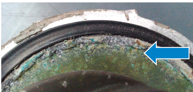
Nieodpowiedni płyn chłodzący doprowadził do korozji i nieszczelności
